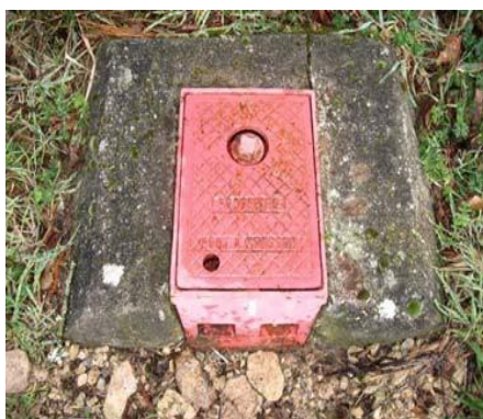
Bouche de lavage fermée
