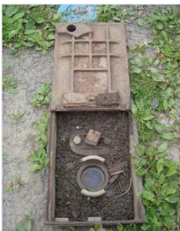
Bouche Incendie de 80 mm à tenons
